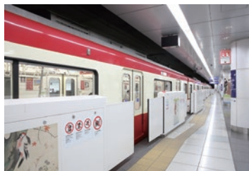
羽田空港国際線ターミナル駅に設置しているホームドア
